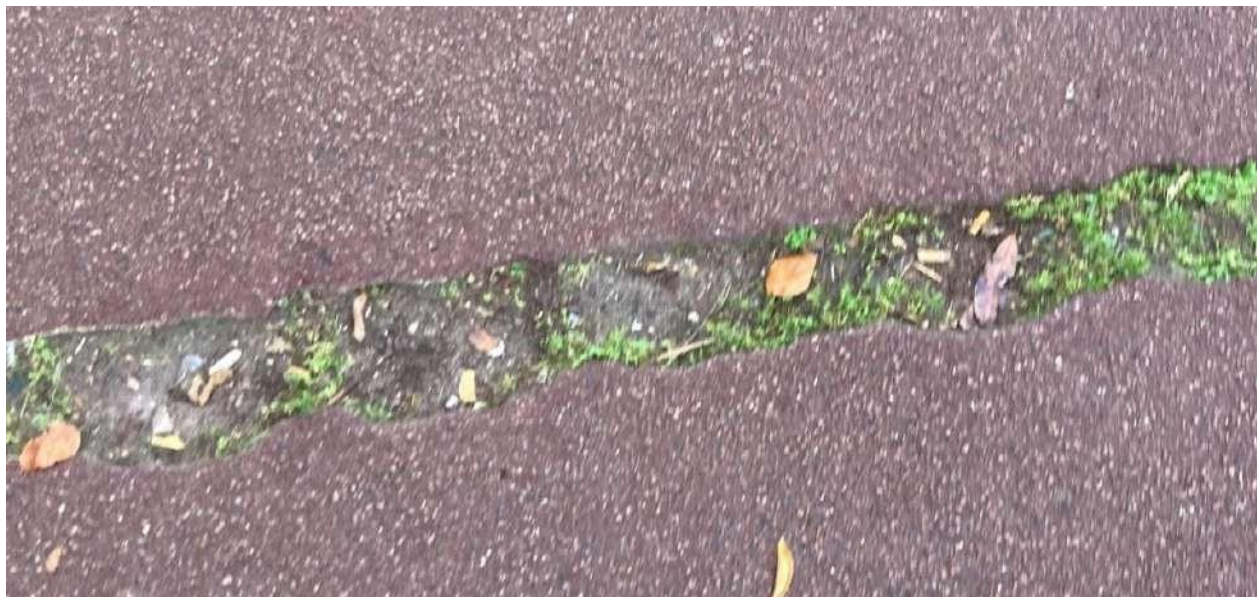
Figure 16 : Large fissure du revêtement sur l'ensemble de la largeur du mail des Mèches, décembre 2024
