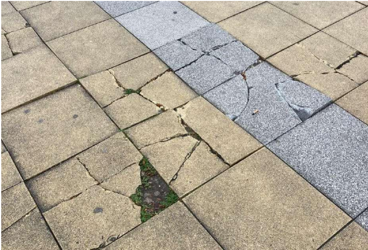
Figure 14 : dalles cassées sur l'esplanade du mail des Mèches, novembre 2024
