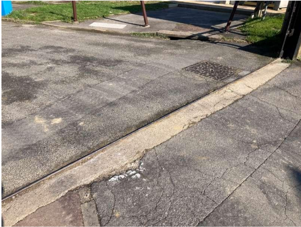
Figure 37 : Irrégularité au sol dû au système coulissant du portail d'accès, un obstacle à franchir à vélo, octobre 2024.
